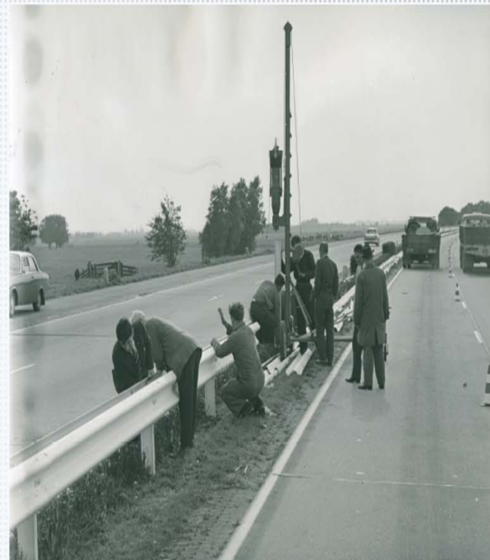
Constructie van een vangrail. Rijksweg 12 kende in 1966 de primeur met dergelijke vangrails.
