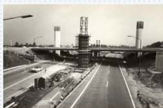
De bouw van het verkeersknooppunt Leidschendam, het latere Prins Claus Plein in 1974/75.
